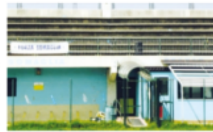
Il nuovo spogliatoio in corso di lavori presso il campo sportivo di Caselle Landi. In alto: l'oratorio di Gerrone
