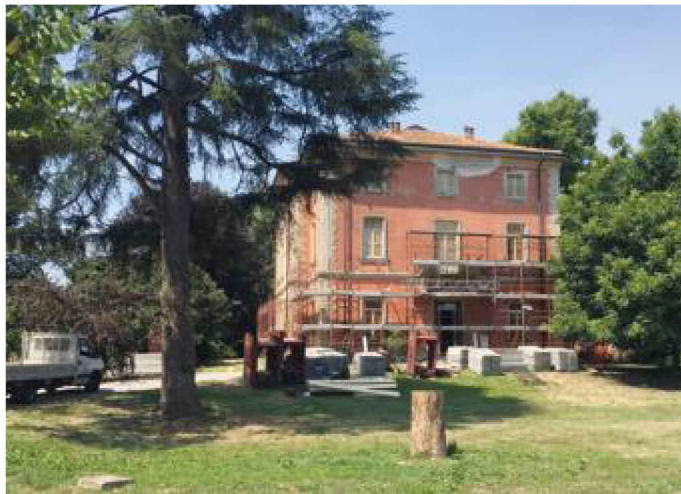
STORICA VILLA In questi giorni è stato posizionato il ponteggio per i lavori
